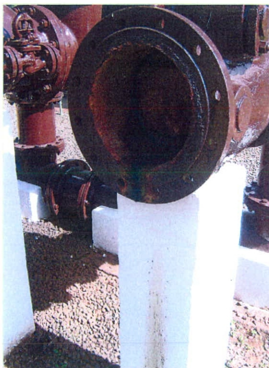
Foto 16: Bocal da bomba, com vazamento
