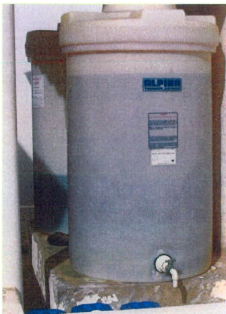
Foto 01 - Vista do tanque de Hipoclorito de Sódio
