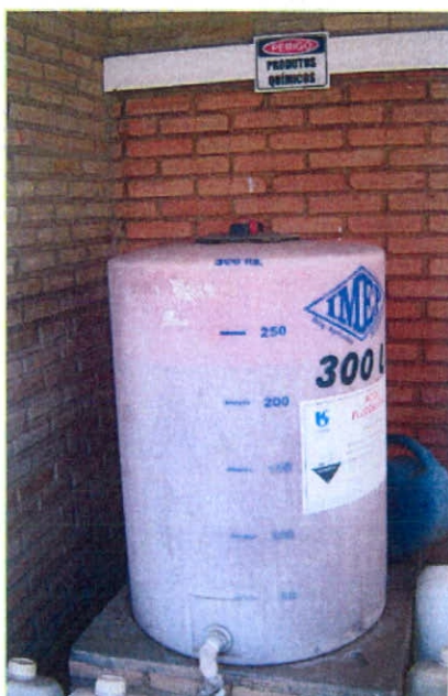
Foto 02 - Tanque de armazenamento de ácido Fluossilícico
