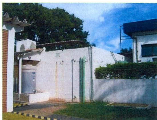
Foto 08 - Reservatório semi enterrado de 260m 3
