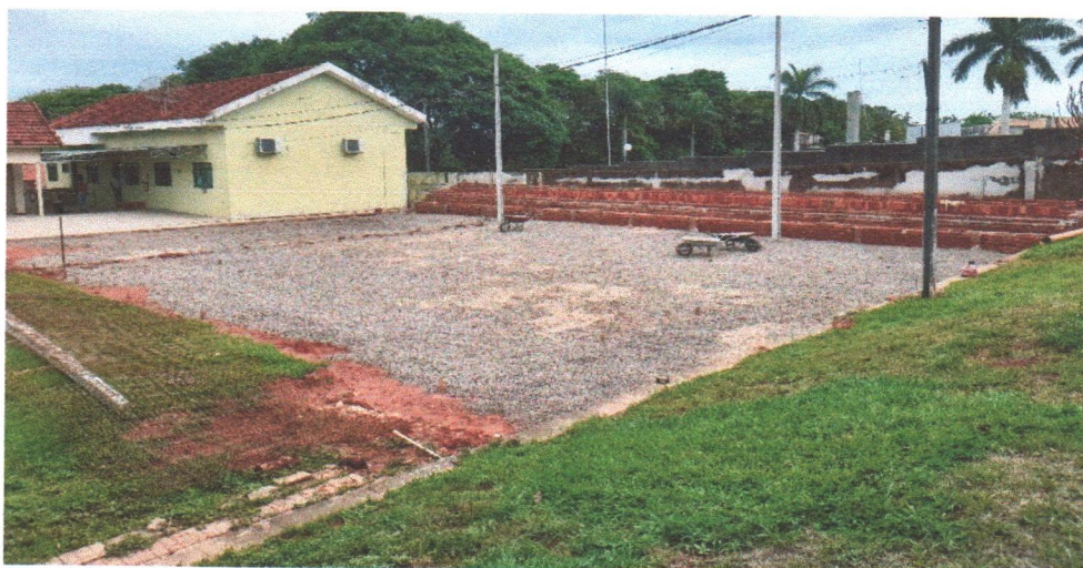
Fotos 4 e 5: Arquibancada em andamento e preparo do piso para recebimento do concreto
